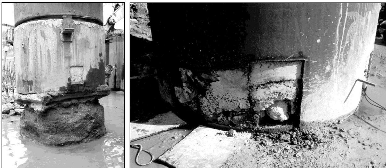
Rys. 9. Głowice pali źle przygotowane do badań dynamicznych
