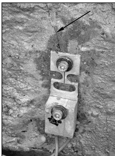
Rys. 8. Pęknięcie głowicy pala w czasie badania dynamicznego
