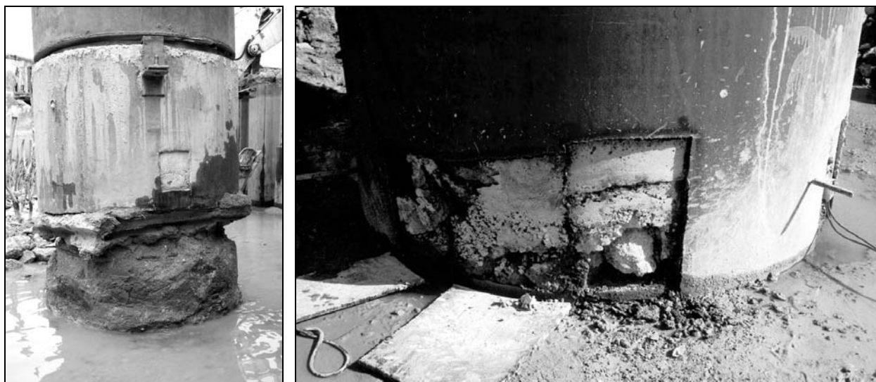
Rys. 7. Głowice pali źle przygotowane do badań dynamicznych
